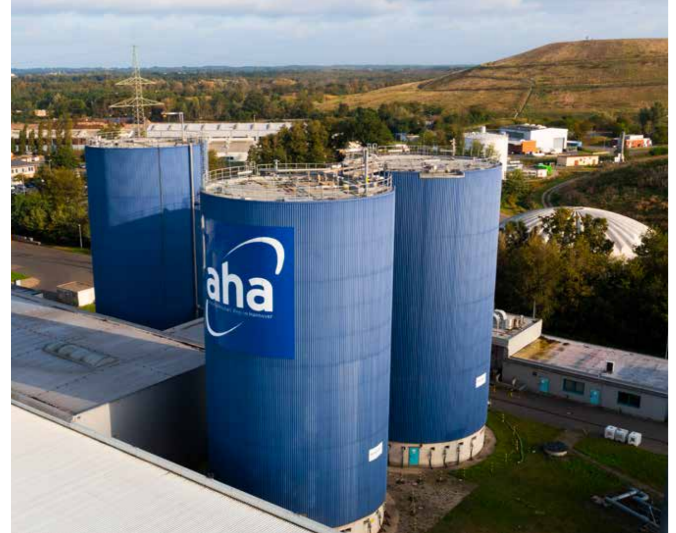
aha nutzt das in den Gärtürmen der Mechanisch-Biologischen Abfallbehandlungsanlage entstehende Methan für die Energiegewinnung.
