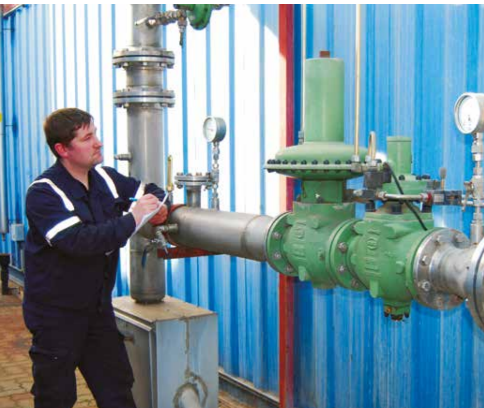
Um die Verstromung des Methangases optimal umzusetzen, muss das Blockheizkraftwerk laufend kontrolliert werden.
